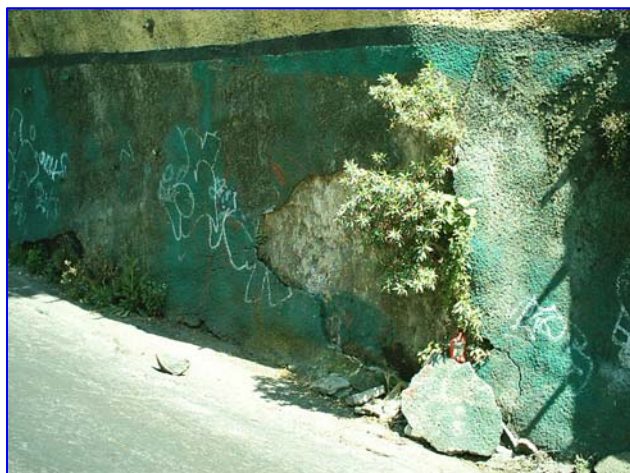
Fig. 13 El zampeo es una medida insuficiente en la estabilidad de taludes
