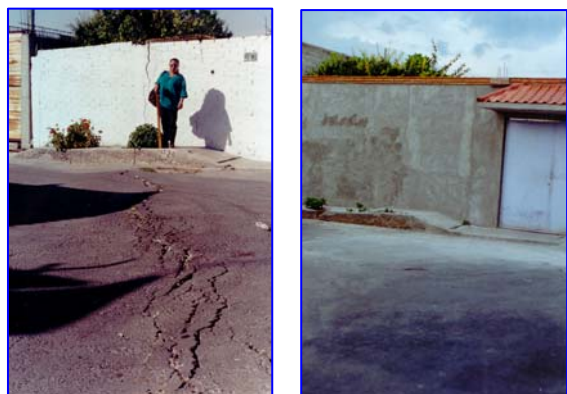
Fig. 5 Grietas de desecación reparadas que se volverán a abrir
