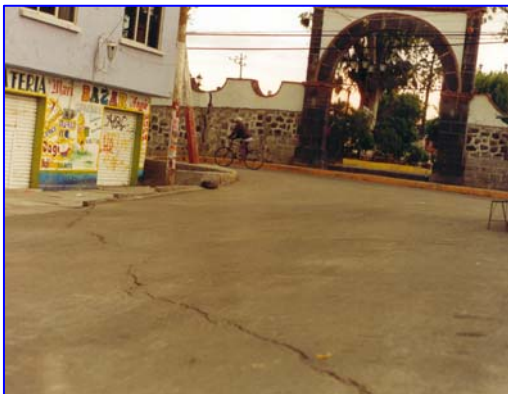
Fig. 4 Grietas de desecación en San Andrés Mixquic, Del. Tlâhuac Obsérvese los escalones contruidos debido al desnivel del terreno
