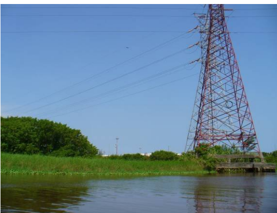
Figura.2.5. Torres eléctricas. Estación 3
